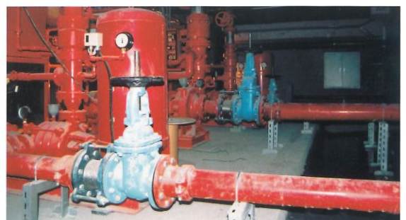
消防機房 16K閥使用實例
