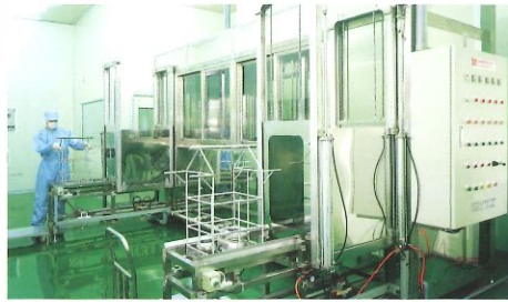
Class 10,000 無塵室 禁油洗淨設備
